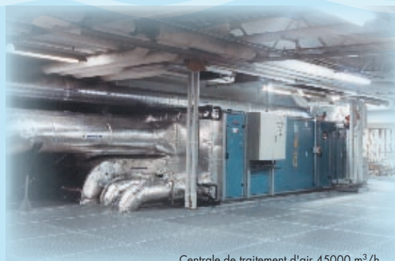
Centrale de traitement d'air 45000 m 3 /h
