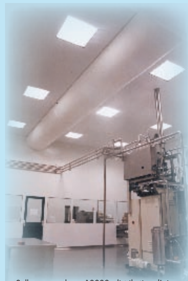
Salle propre classe 10000, distribution d'air par gaine poreuse mono filament
