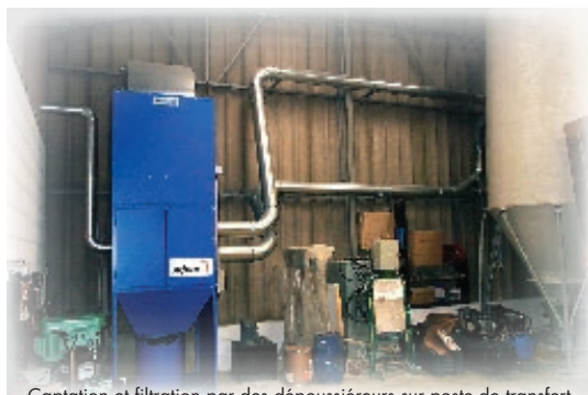
Captation et filtration par des dépoussiéreurs sur poste de transfert
